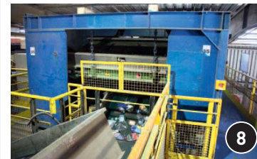
8 Vient alors la récupération de l'acier des corps creux via un Overband (électro-aimant). Les corps creux restant sur le tapis poursuivent alors leur parcours.
